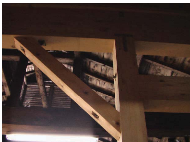
【再建後の店舗内(ボルトが丸見えになっている)】
